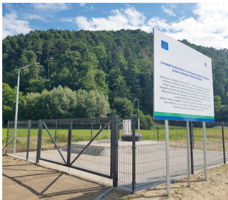
► Przepompownia ścieków Melsztyn
