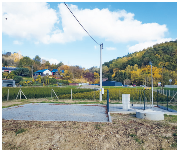
► Przepompownia ścieków Roztoka
