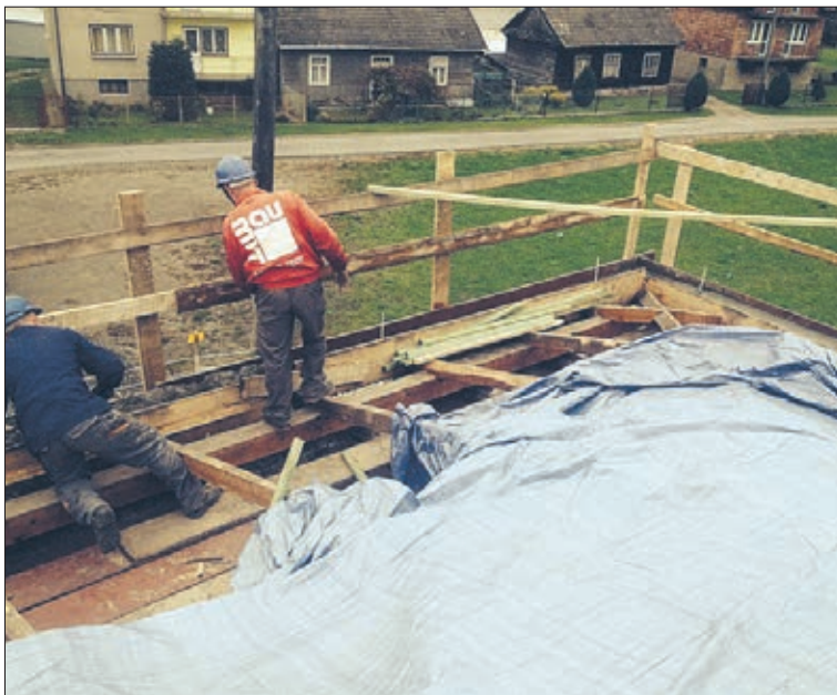
Zerwanie poszycia dachu
